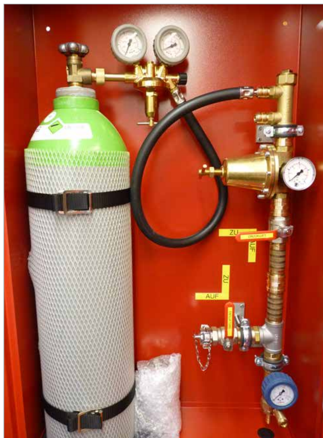
Stazione di controllo
