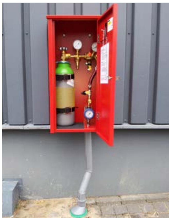
Stazione di controllo
